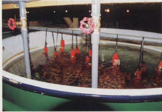
B・M・W (生物活性水) プラントでのエアレーション
